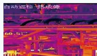
热成像巡检系统
