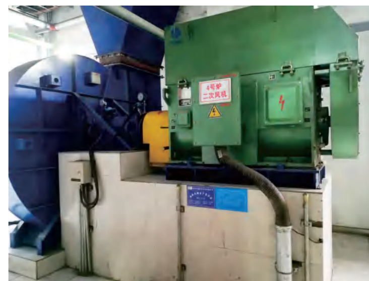
如东协鑫环保热电有限公司变频改造后的4号锅炉二次风机
